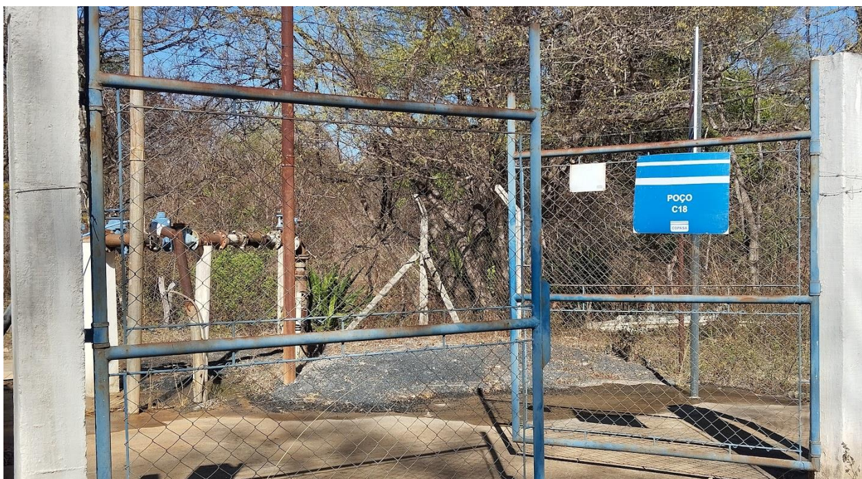
Figura 5.11 - Ponto de captação subterrânea monitorada pela companhia de abastecimento.
